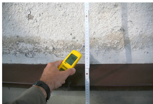
Fot. 1. Ściana zewnętrzna parteru od strony ulicy - stan mokry (ok. 140 J) na rzędnej +0,70 m nad poziomem gruntu
