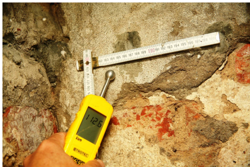
Fot. 3 Piwnica - ściana zewnętrzna - stan wilgotny (ok. 113 J) na rzędnej +1,80 m nad posadzką (miejsce wykonania wcześniejszej iniekcji pod stropem piwnicy)
