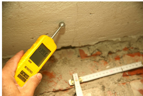
Fot. 4 Strop nad piwnicą - stan wilgotny (ok. 140 J)
