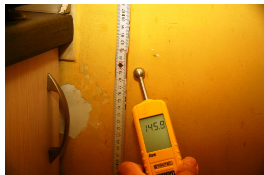
Fot. 2 Ściana zewnętrzna w pom. kuchni mieszkania nr 1 na parterze - stan mokry (ok. 146 J) na rzędnej +0,70 m nad podłogą parteru
