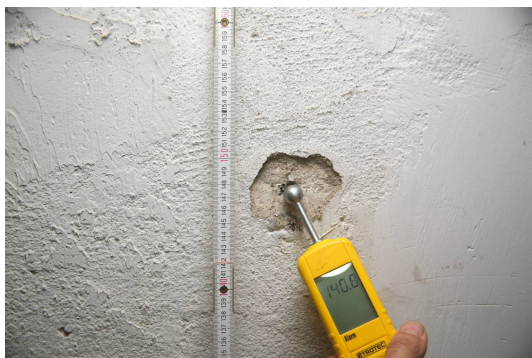
Fot. 5 Piwnica - korytarz - stan wilgotny (ok. 141 J) na rzędnej +1,50 m nad posadzką
