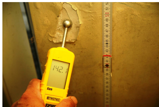
Fot. 6 Parter - klatka schodowa ściana zewnętrzna przy wejściu do budynku - stan wilgotny (ok. 142 J) na rzędnej +0,50 m nad posadzką
