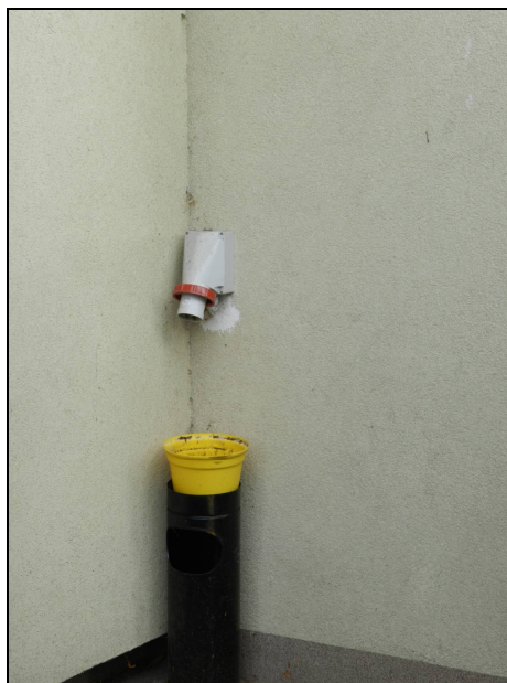
Fot. 5.4. Widok alternatywnego wypustu służącego do przyłączenia przenośnego agregatu prądotwórczego
