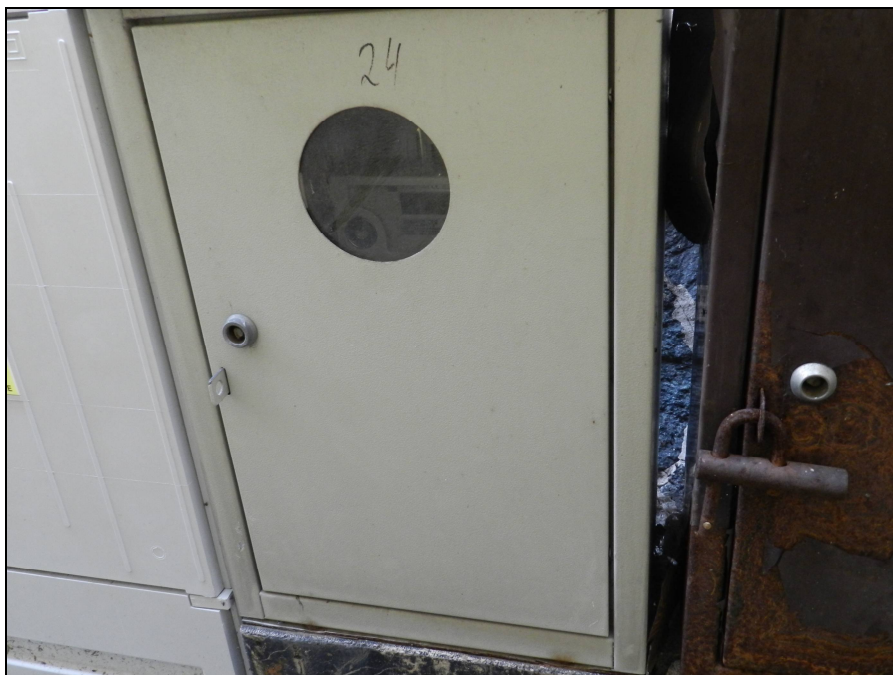
Fot. 5.2. Widok szafy układu pomiarowo-rozliczeniowego dla punktu poboru energii elektrycznej PPE_ORLE01 (nr PL0037360066171677)
