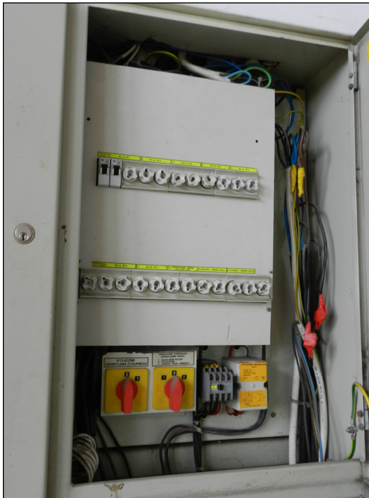
Fot. 6.1. Widok rozmieszczenia aparatury łączeniowo-zabezpieczającej i sterującej oświetleniem w rozdzielnicy głównej
