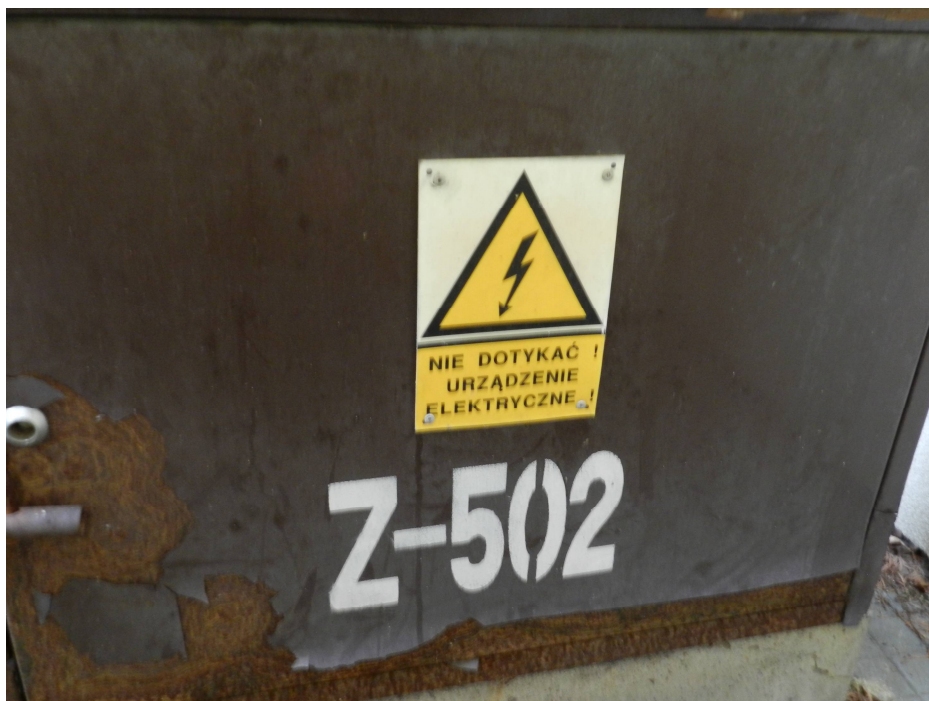
Fot. 5.1. Widok szafy złącza kablowego budynku
