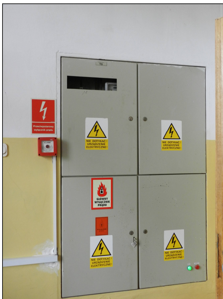
Fot. 5.5. Widok umiejscowienia szaf zawierających układ pomiarowo-rozliczeniowy, główną rozdzielnicę budynku, główny wyłącznik zasilania elektroenergetycznego oraz przełącznik źródła zasilania
