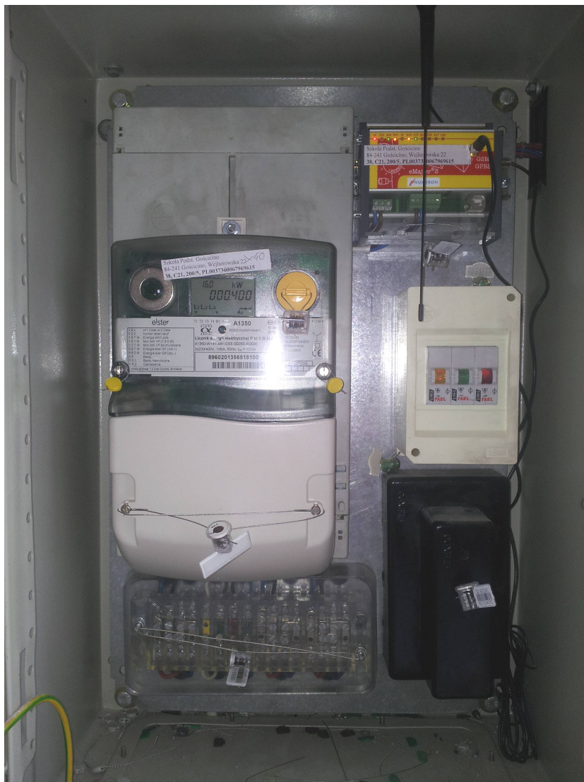
Fot. 3. Widok układu pomiarowego zainstalowanego w szkole
