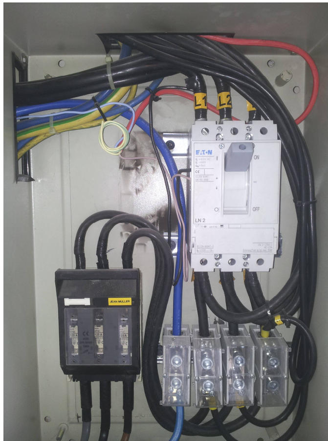
Fot. 2. Widok przyłącza zasilającego budynek szkoły
