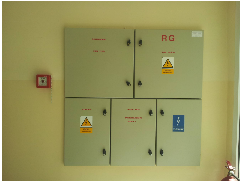
Fot. 1. Widok szaf z rozdzielnicą główną, układem pomiarowym, wyłącznikiem głównym i ochronnikami przeciwprzepięciowymi
